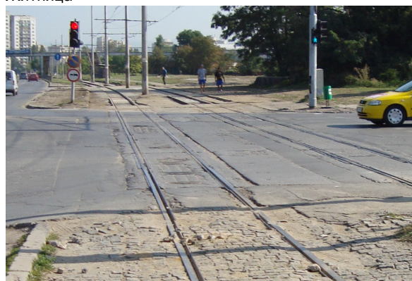
Фигура 5.4: Дупки по настилната и разрушени бордюри – кръстовище „бул. Овча Купел – ул. Житница”
