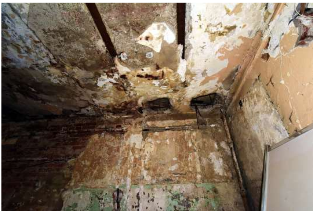
Ръждясали подови метални греди , олющени стени , пукнатини
